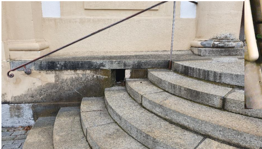
Schadhafte Fassadenstellen Hauptgebäude
